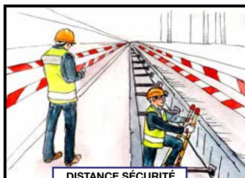
DISTANCE SÉCURITÉ EXCAVATION >= à 1 m
